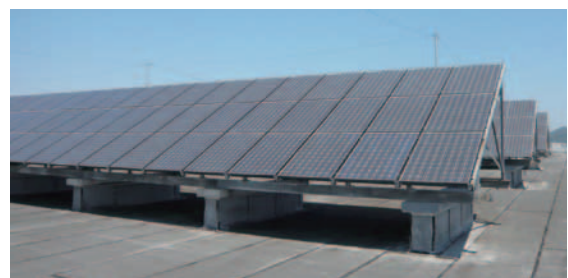
鳥取工場の太陽光発電パネル
